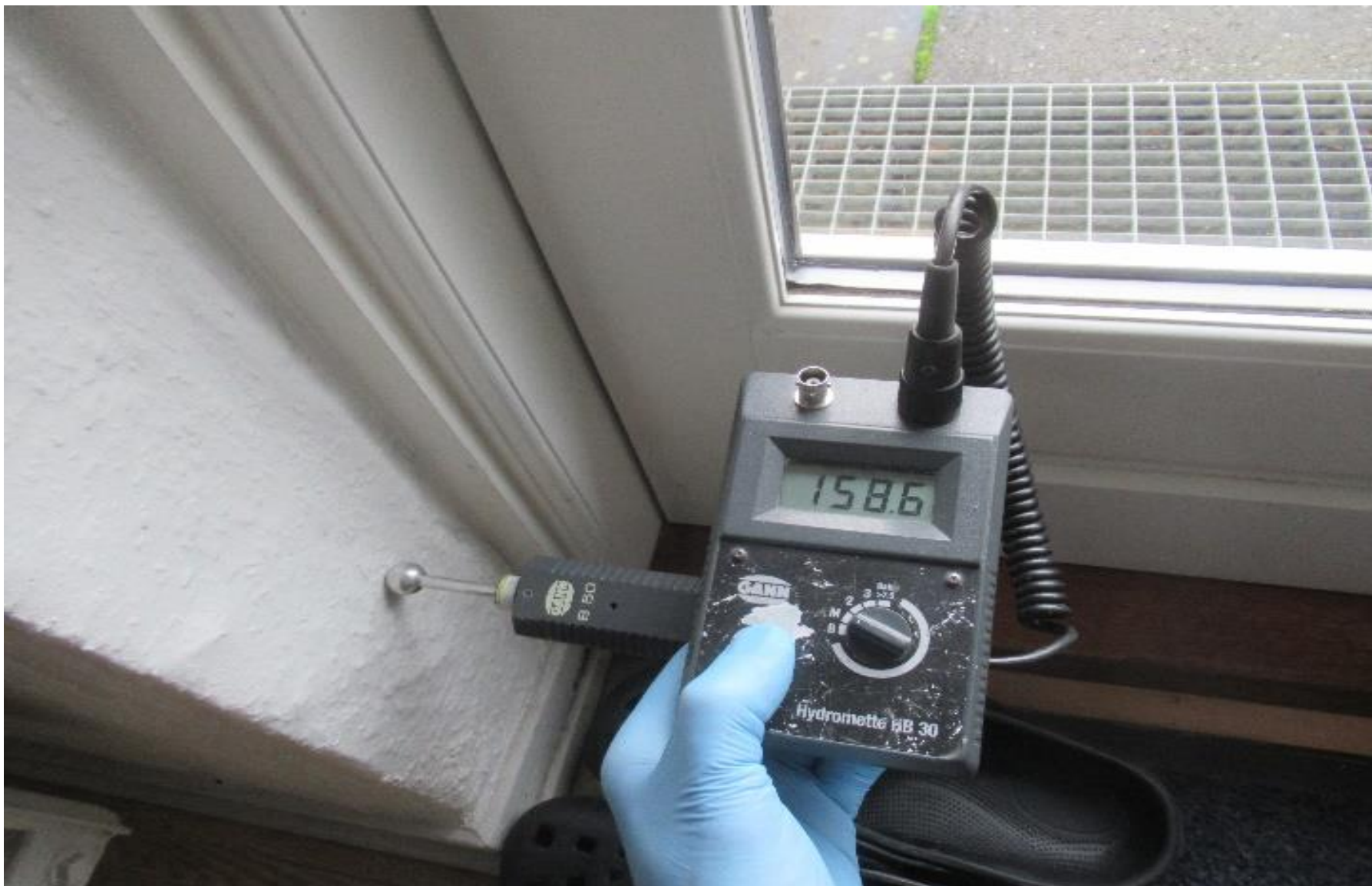
Eksempel på kraftig opfugtning.
