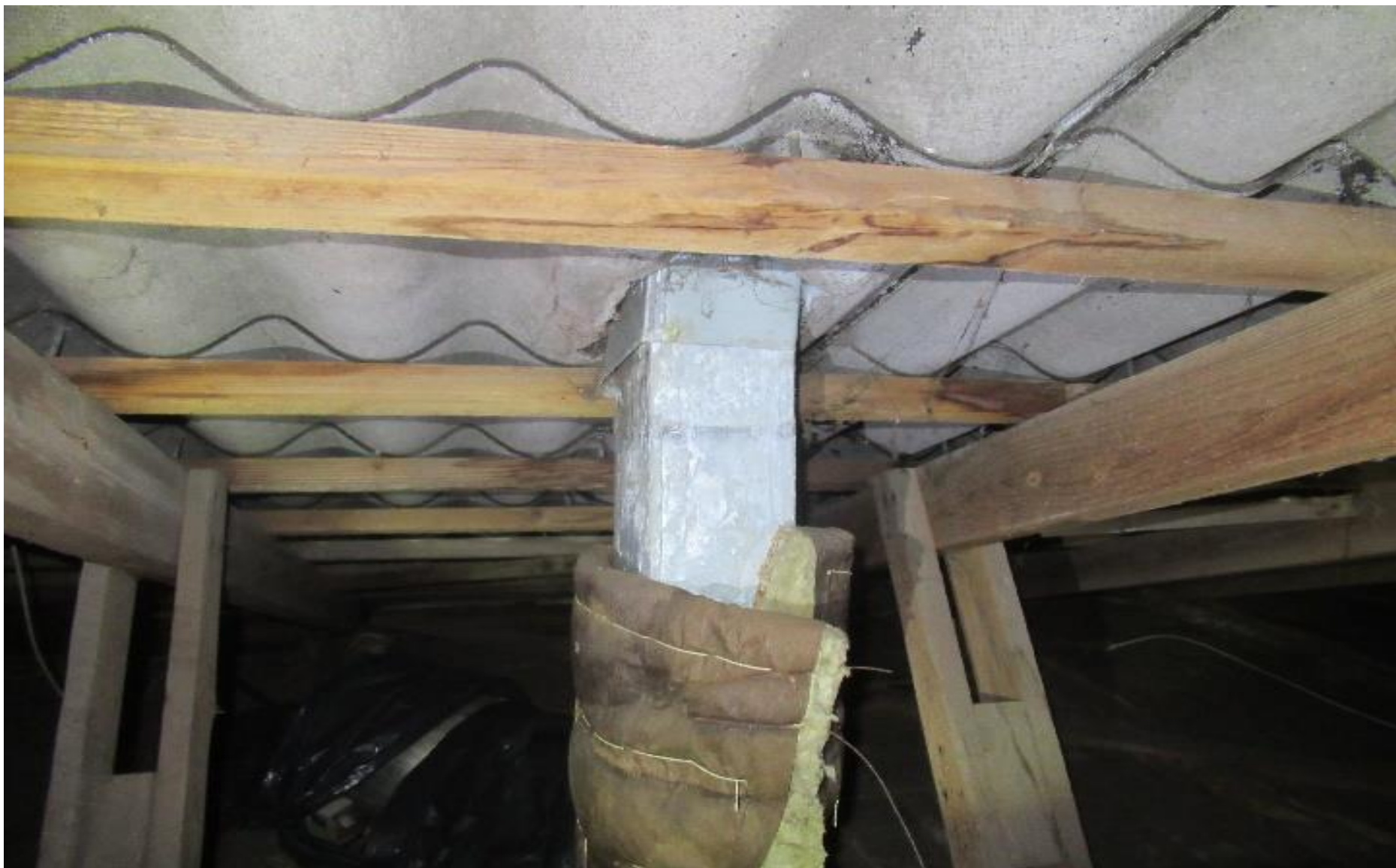
Eksempel på manglende kondensisolering på aftrækskanaler.
