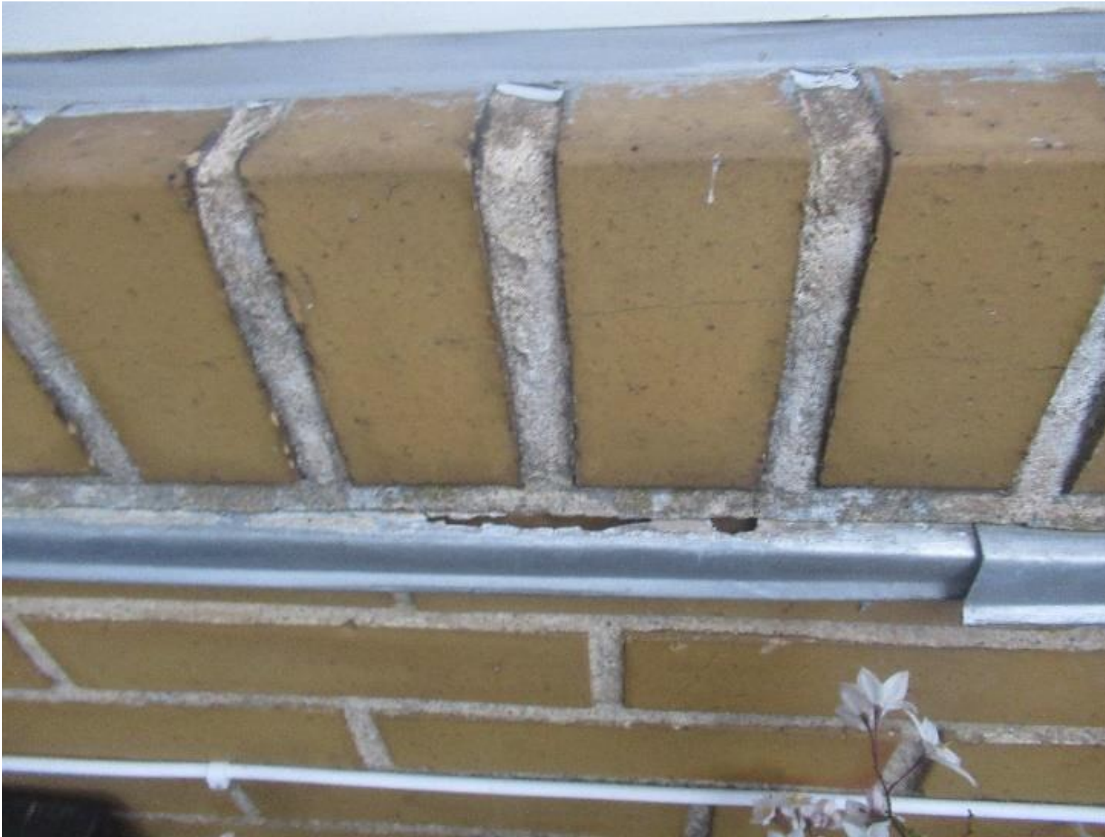
Eksempel på korrosion af zinkinds kud.
