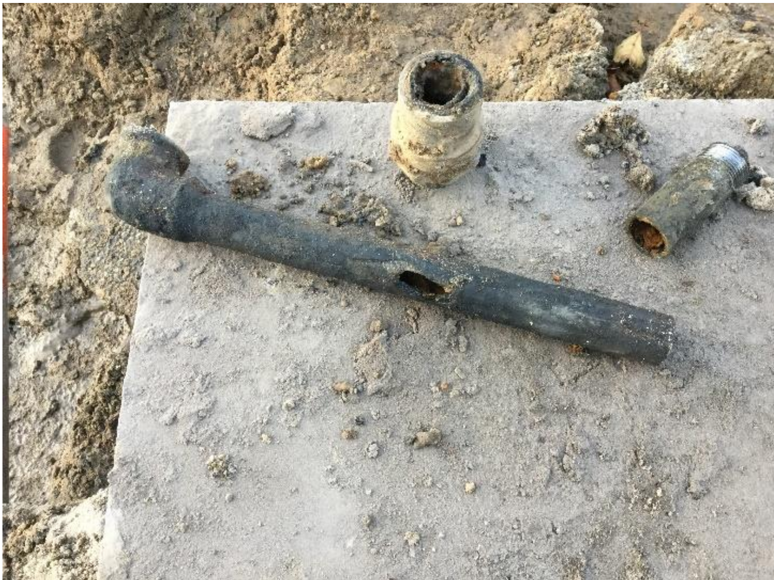
Korrosion har ført til brud – Kløvervej 12, foto: FællesBo.
