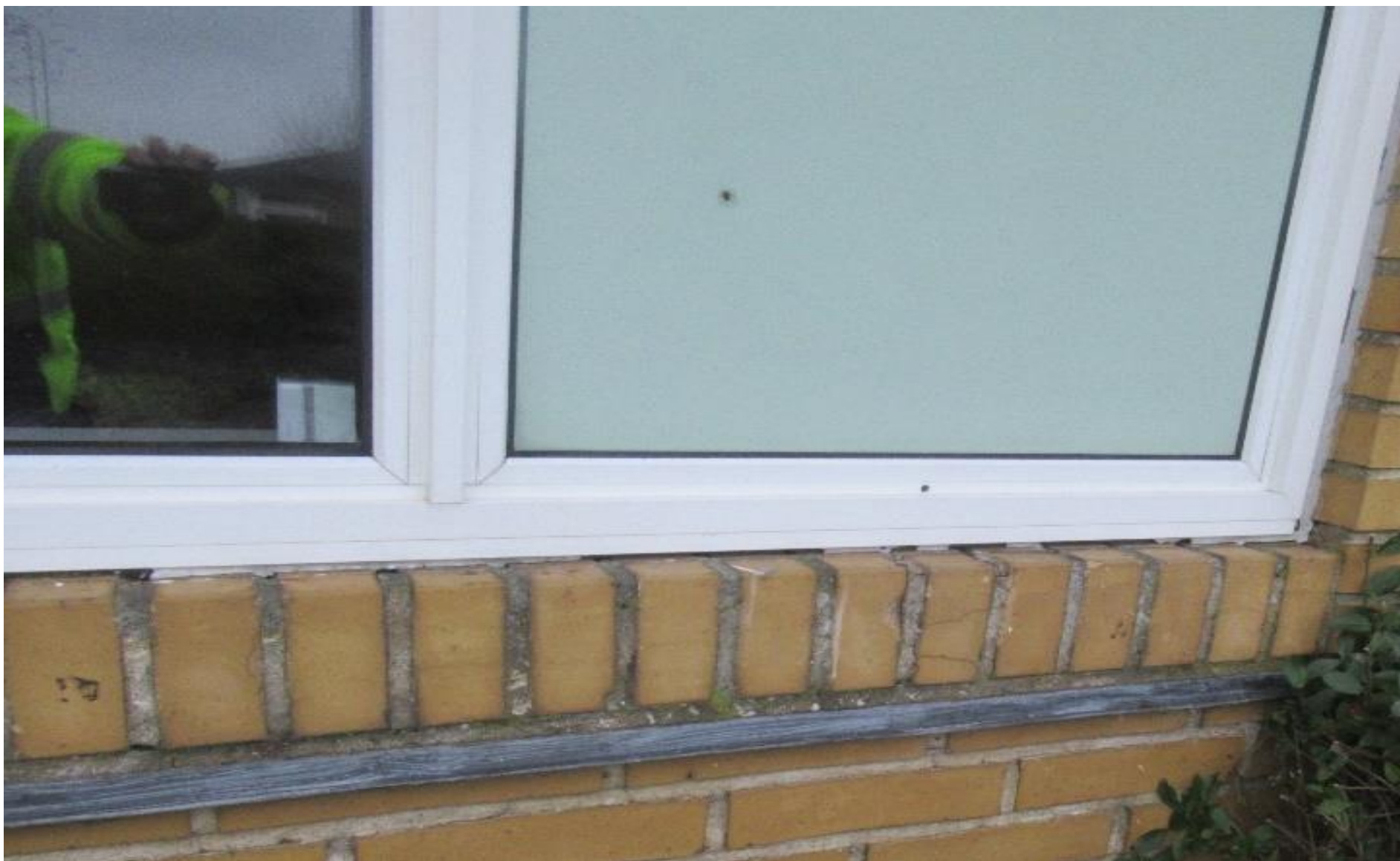
PVC- vinduer årgang 1995, manglende / nedbrudte kalfatringsfuge
