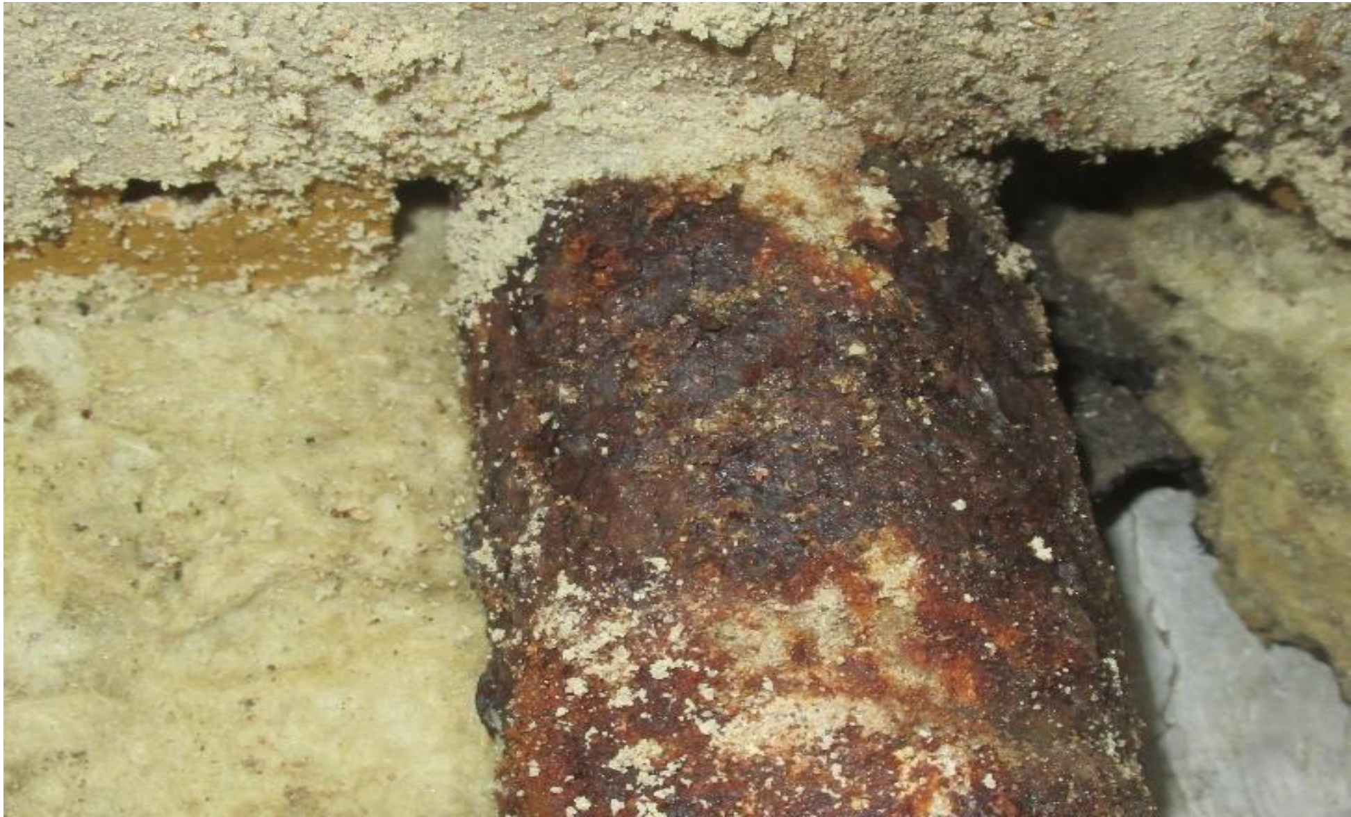
Eksempel på kraftig rusttæring i bærende stålsøjler.
