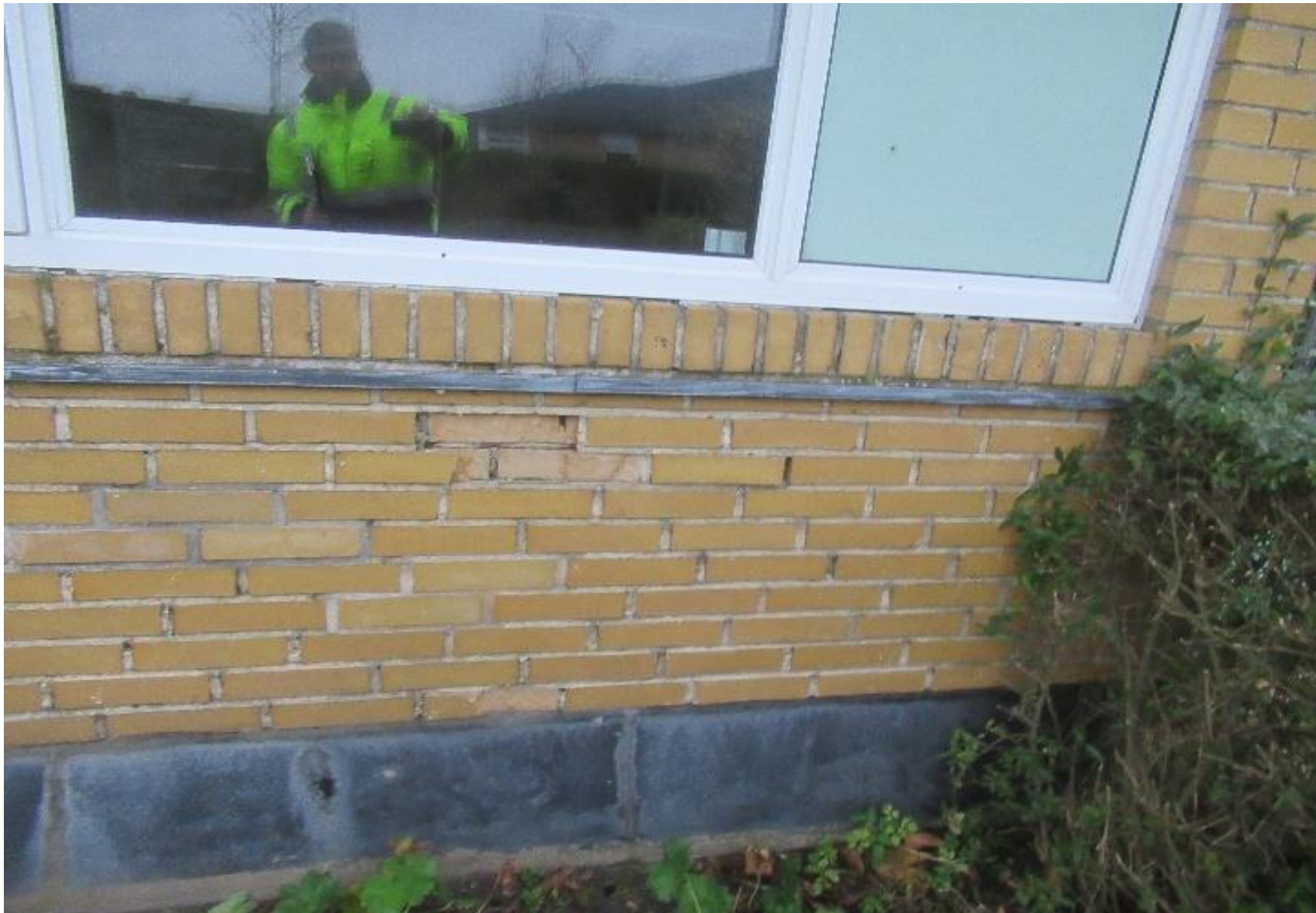
Eksempel på nedbrydning af murværk.
