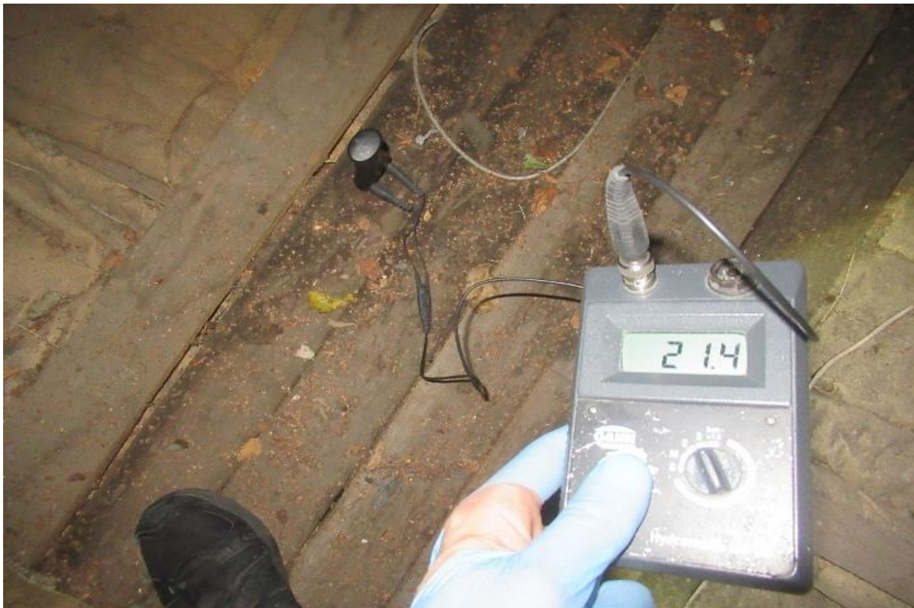
Eksempel på opfugtning af træværk – her gangbro.
