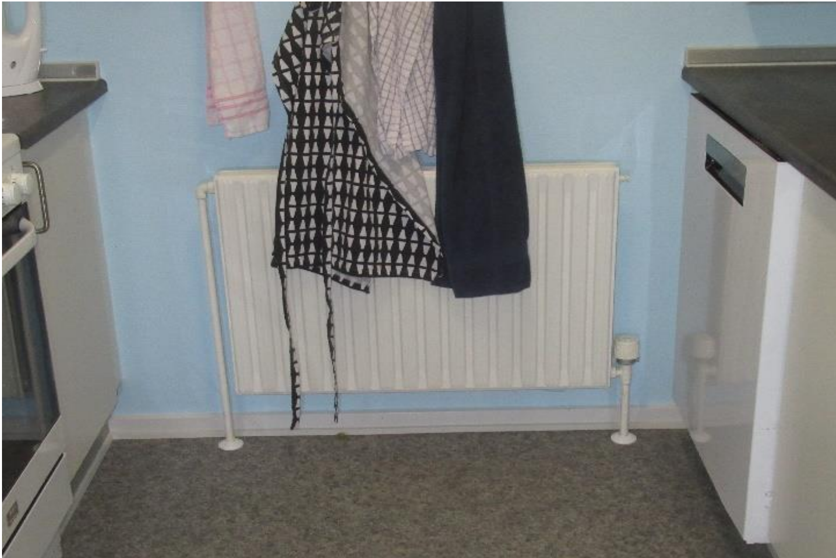
Eksempel på varmeanlæg.
