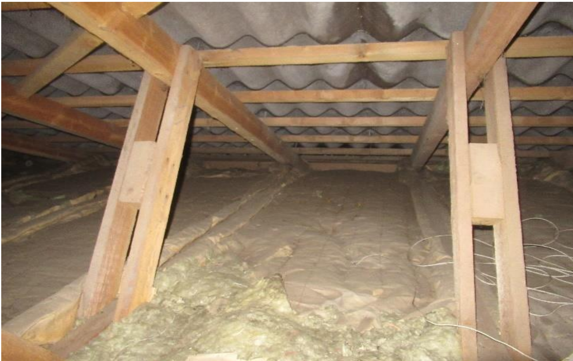
Bølgeplader med asbest – 52 år gl.
