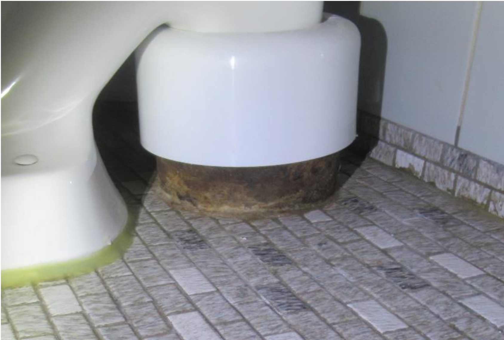
Afløbsinstallationer af støbejern i terrændæk.
