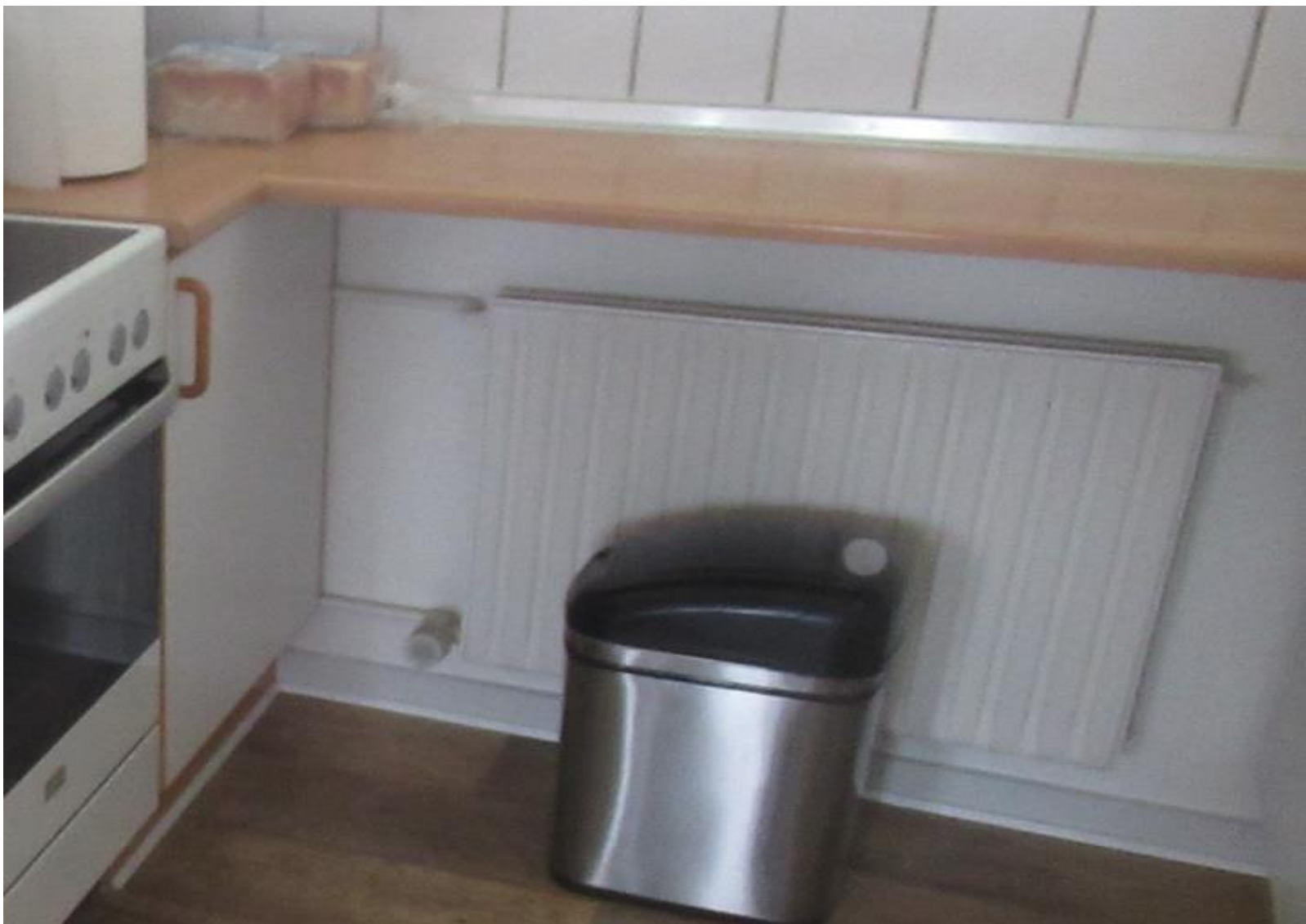
Eksempel på varmeanlæg.
