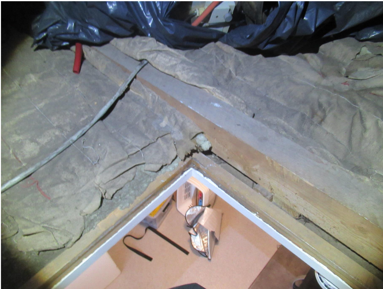
Eksempel på loftslem uden isolering.
