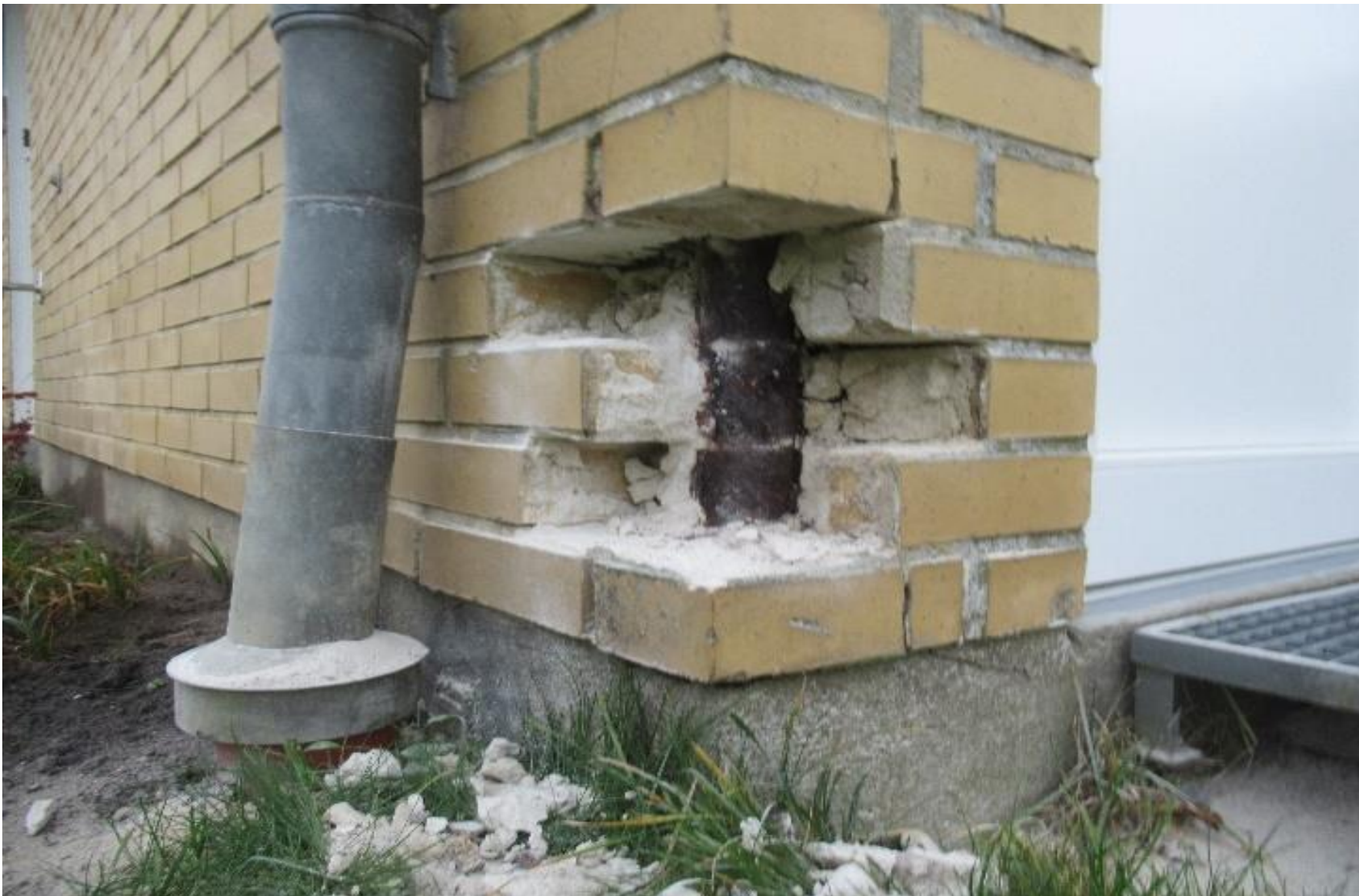
Eksempel på rusten - bærende stålsøjle.
