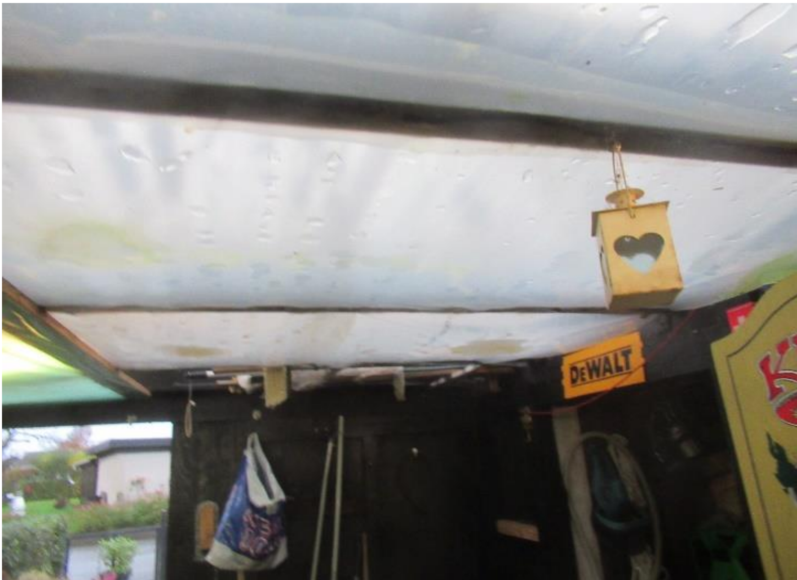
Eksempel carport med utæt tag.
