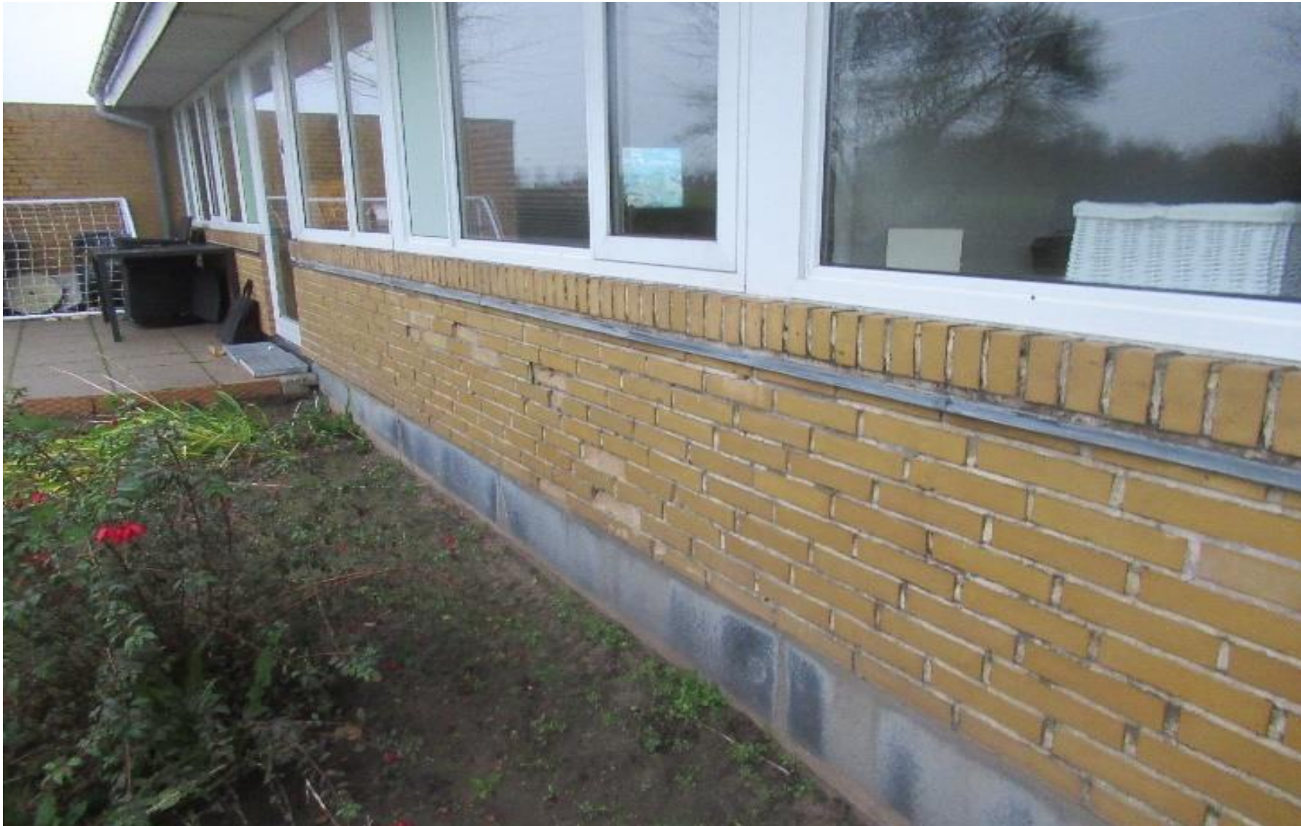
Eksempel på revnedannelser i sokler.
