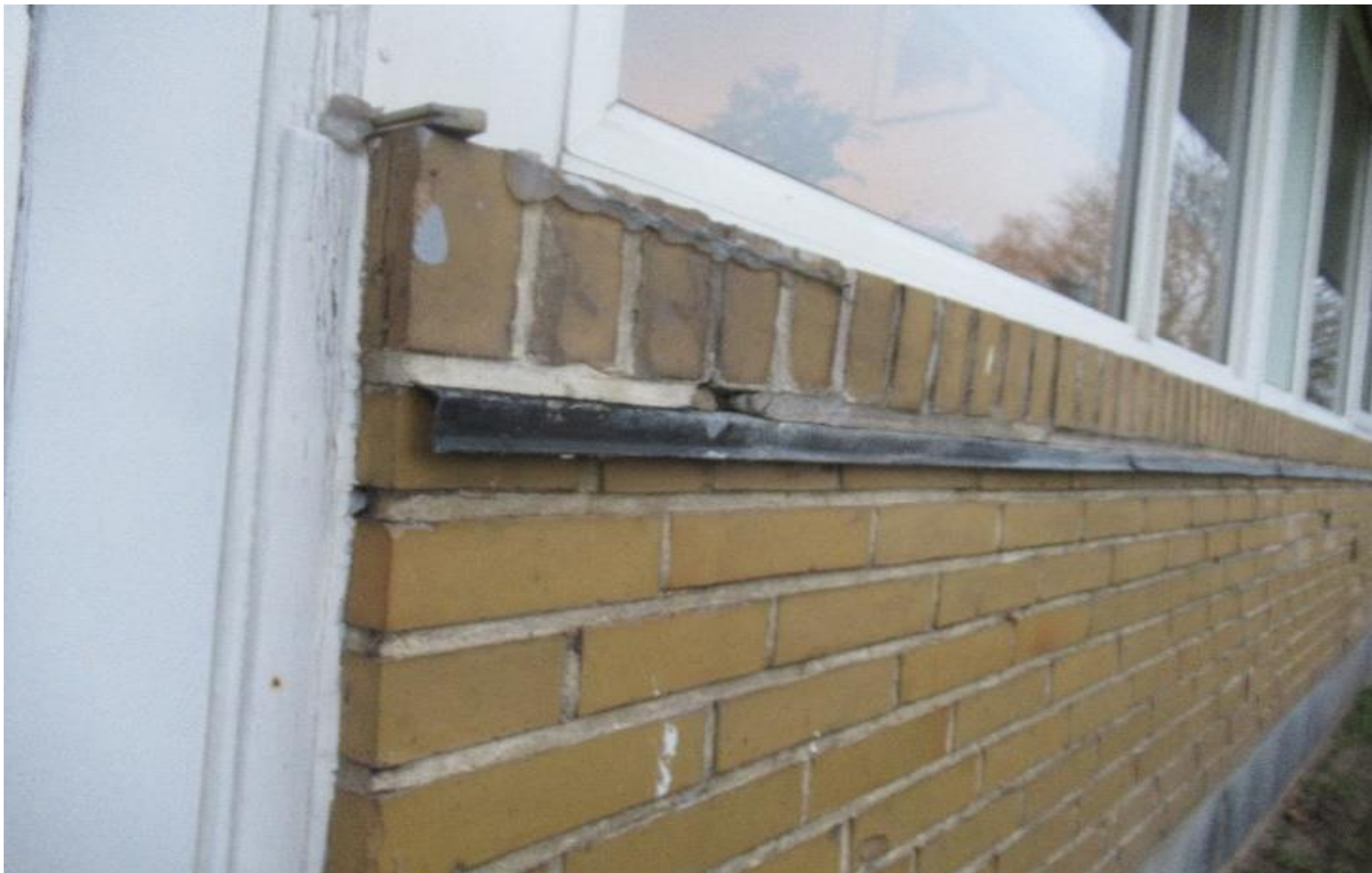
Eksempel på dårlige fuger i murværket.
