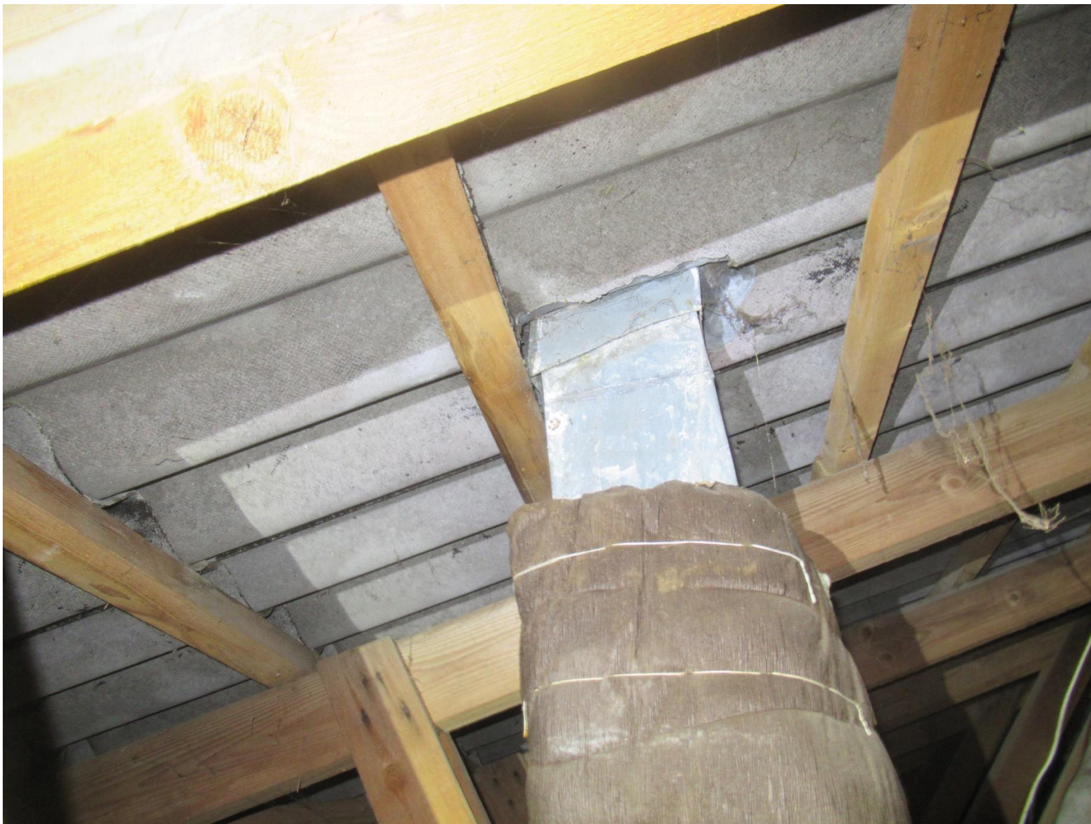
Eksempel på manglende kondensisolering på aftrækskanaler.
