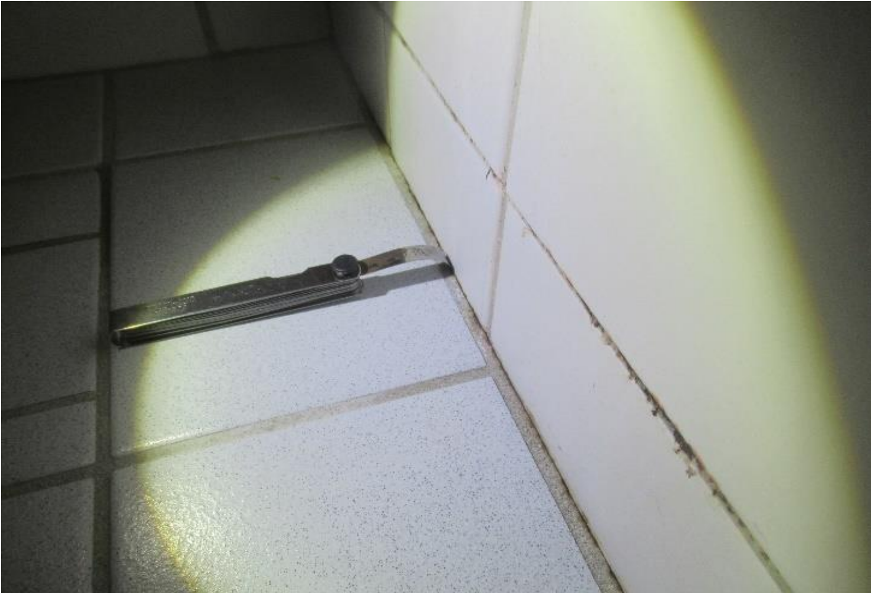
Eksempel revnet fuger i overgang mellem gulv og væg i bruseniche .
